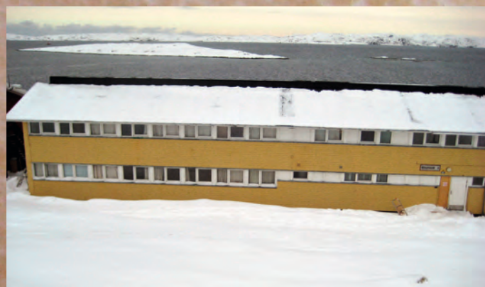
100 collegiepladser er sundhedsfarlige. Der er både svamp og asbest i de to ældste blokke. Det giver eleverne allergi.
