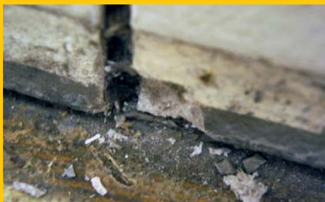
Her er asbesten, der er skrabet i med en negl, mens linoliummet bliver skiftet.
